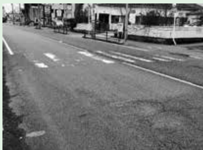
区画線が消えた横断歩道
